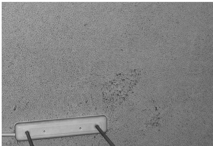
写真3 局所的な表面の毛羽立ち*のある吹付けアスベストの例（天井面）
