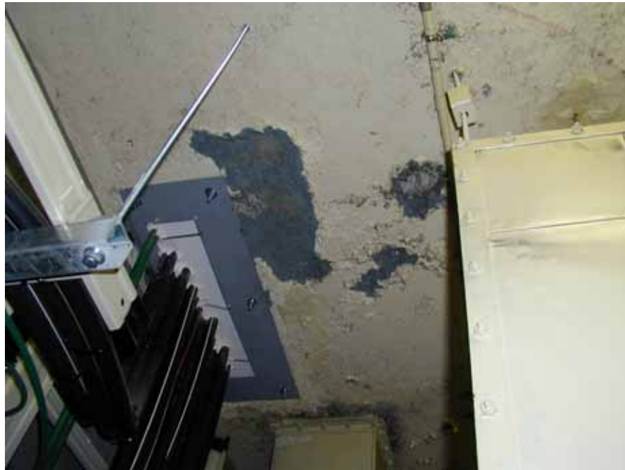
写真1 損傷・欠陥*に至った吹付けアスベストの施工例
