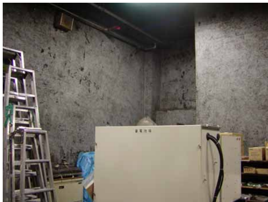
写真2 全面に繊維のくずれ*のある吹付けアスベストの施工例
