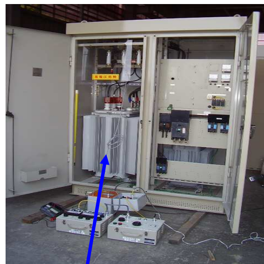
キュービクル内のトランス(変圧器)
